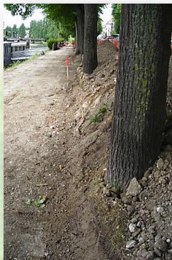
Décaissage trop proche du système racinaire.
