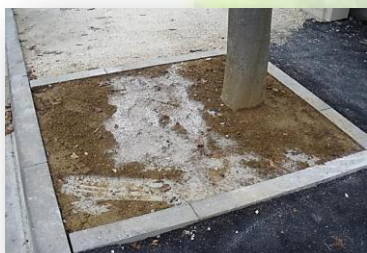
Epannage de fluides toxiques et réduction du système racinaire pour poser les bordures.
